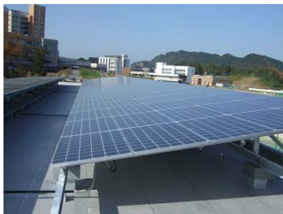
課外活動施設屋上の太陽光発電
